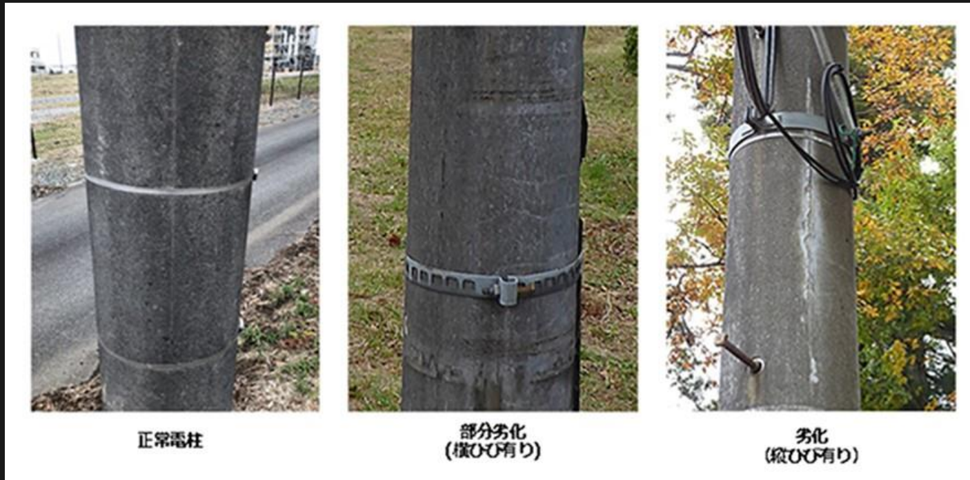
正常電柱と劣化電柱の比較
